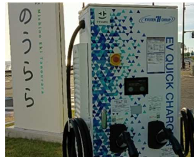
道の駅のEV充電機器)
